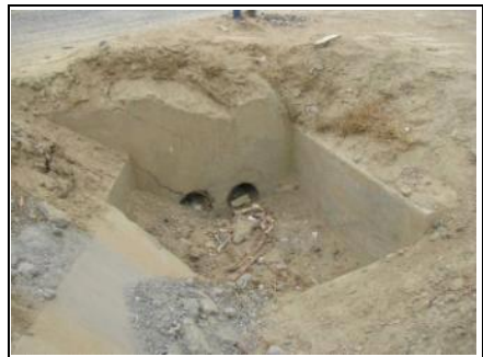
Foto 04: Ingreso de alcantarilla de desfogue en inicio de tramo, dos tuberías Ø 8" cada una. Cabezal de ingreso en malas condiciones y obstruido.
